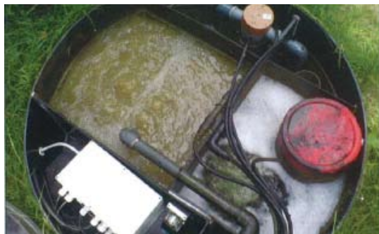
Billede 1: Overbelastet minirenselanlæg pga. slamflugt fra bundfældningstanken, som har forårsaget brunt spildevand i renseskammeret.
