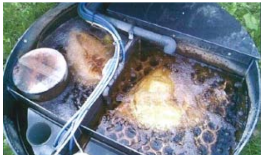
Billede 2: Minirenselanlæg med installeret sorptionsfilter i begge renseskamre
