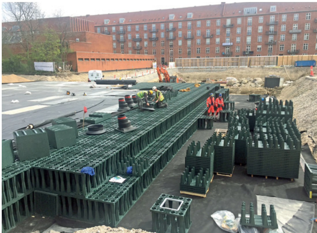
Under membranen ses de mange regnvandsfaskiner, som bassinet er bygget op af.
